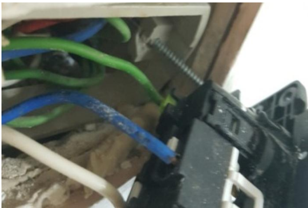
매립박스 파손 사례 1
