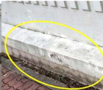
1층 측면부 외벽 하단부 Paint discoloration 도장변색
