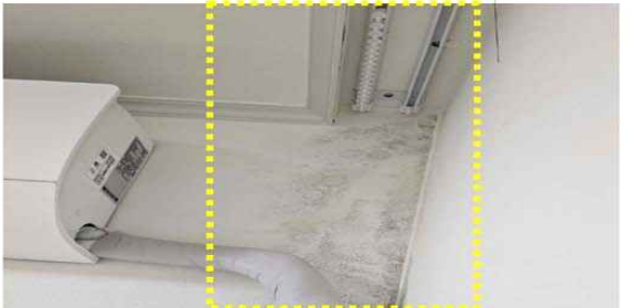
침실1천정&벽채 유출 피해사진
