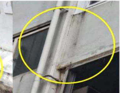
외벽 후면부 외벽 크랙 Paint discoloration 도장변색
