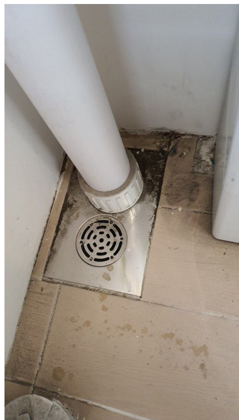
청소상태 불량 사진 2 - 보일러/에어컨 실 얼룩/먼지 (입주 시 존재)
